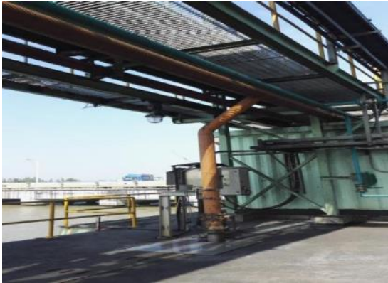
码头集水井水泵
