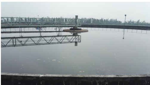
照片 5 二期二沉池
