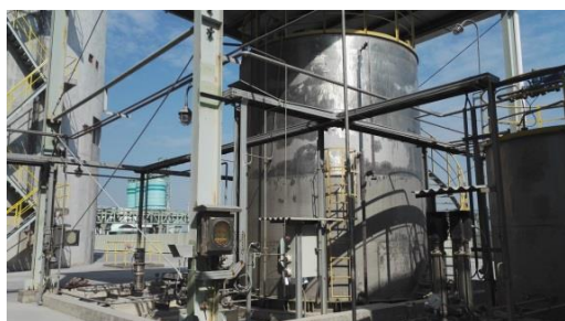
照片 19 氨水储存罐
