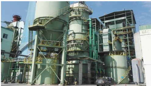
照片 3 烟气处理装置
