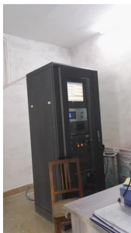
照片 7 废气在线监测仪
