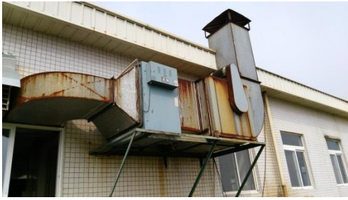
照片 1 厨房油烟装置
